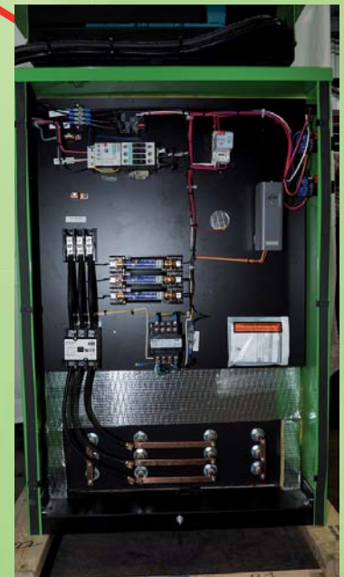
Panneau électrique Electrical panel
