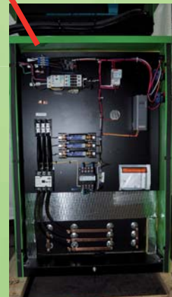
Panneau électrique Electrical panel
